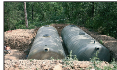
Instalación modular sin cubeto de obra.
