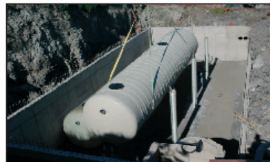
Equipo de 50 m³ en cubeto de obra para tráfico rodado.
