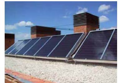
Figura 7.30. Instalación solar integrada a un edificio.
