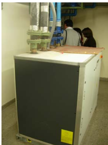
Figura 7.41. Bomba de Calor geotérmica marca Ciatesa instalada en edificio PDI Puerto Montt.
