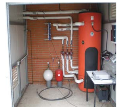
Figura 7.31. Monitorización instalación solar para abastecimiento A.C.S.
