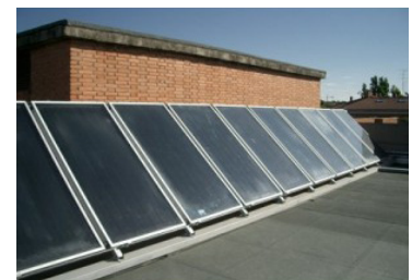
Figura 7.12. Conjunto de colectores planos.
