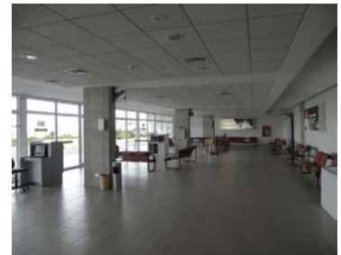
Figura 6.36. Acondicionamiento acústico en áreas comunes. Pasillo con presencia de material absorbente en el cielo.
