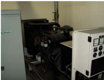
Figura 6.41. Las salas de bombas y de generación eléctrica sin el respectivo control de ruido pueden generar molestias a causa de sonidos intrusivos y transmisión de vibraciones mecánicas.
