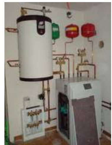
Figura 7.39. Bomba de Calor geotérmica con estanco acumulador.
