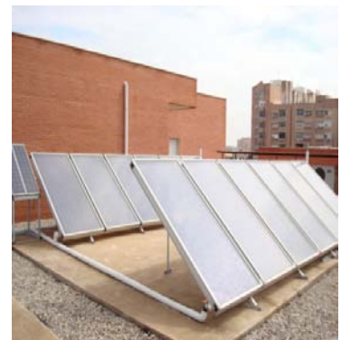
Figura 7.29. Instalación solar para edificio.
